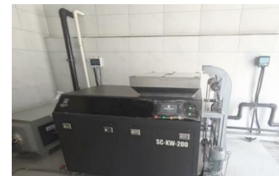
廚餘消化系統 Food waste digester
